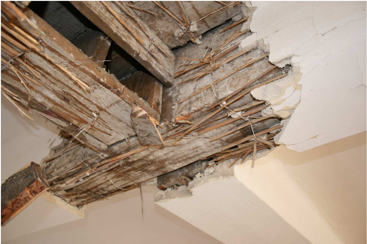
FOT.06. Widoczne obsunięcie belki drewnianej z desek względem dolnego pasa więzara – ściągu.
