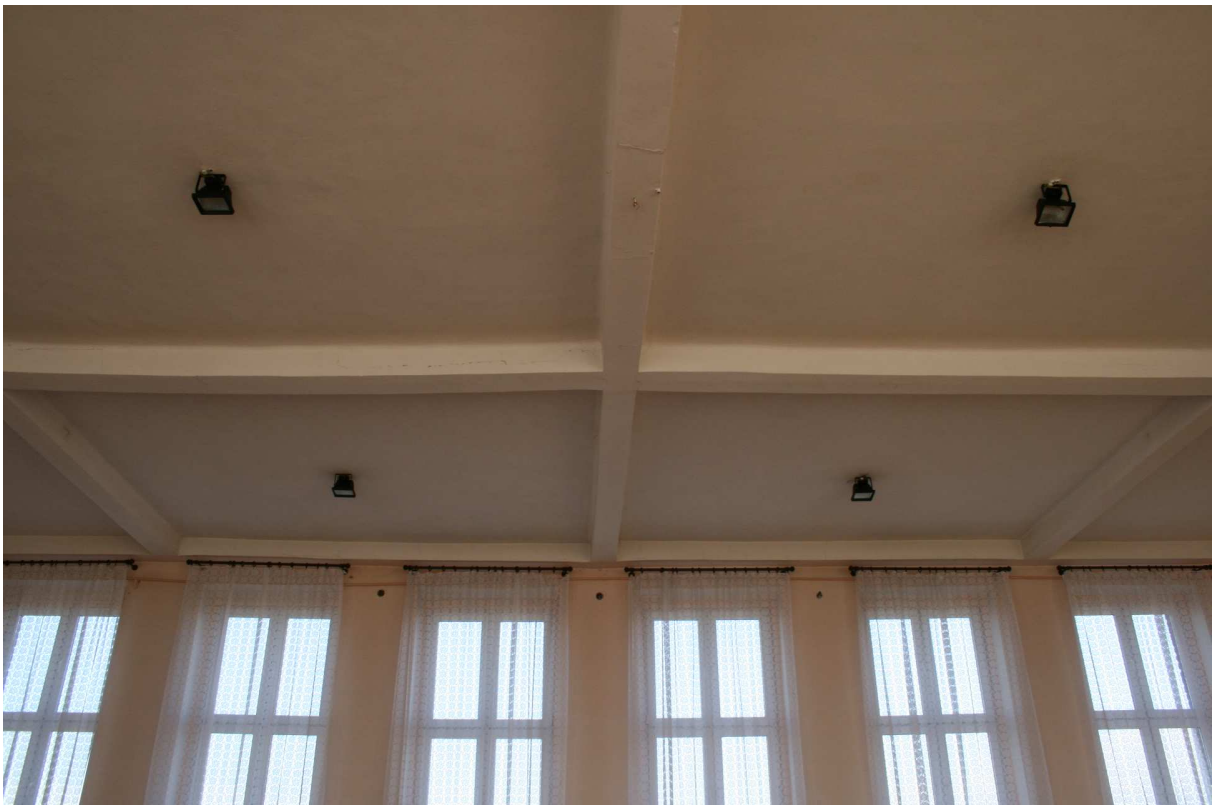
FOT.03. Widoczne nadmierne ugięcia podłużnych belek stropowych.
