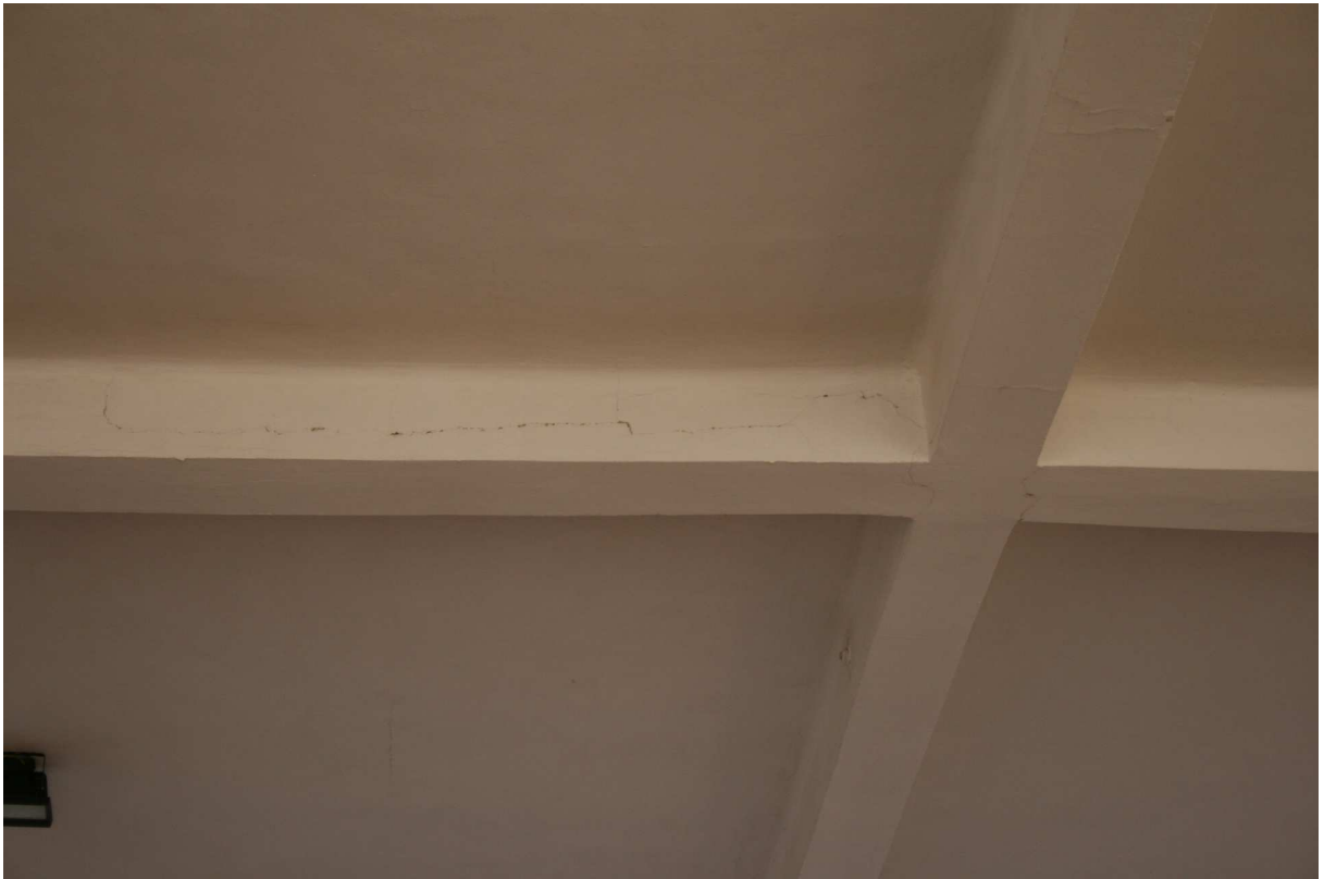
FOT.04. Widoczne spękania tynku na podłużnych belkach drewnianych.
