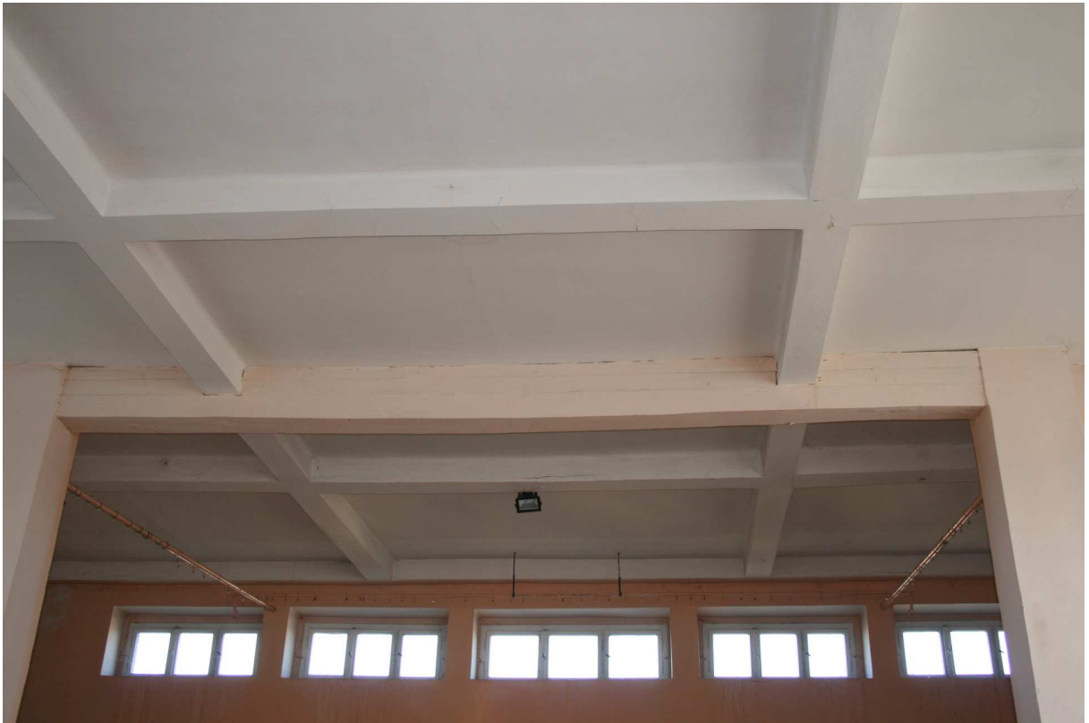
FOT.02. Zdeformowana belka nad sceną sali widowiskowej zbita z desek.
