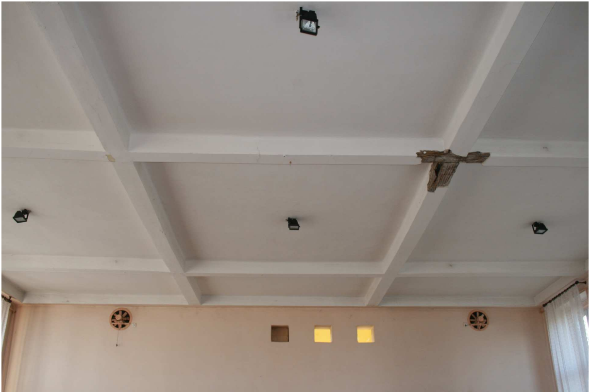
FOT.08. Zniekształcenia i deformacje belek pod stropodachem.
