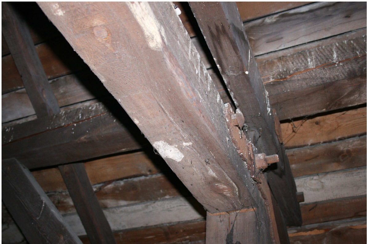
FOT.13. Skorodowany i poluzowany łącznik stalowy pomiędzy zastrzałem a rozporem.
