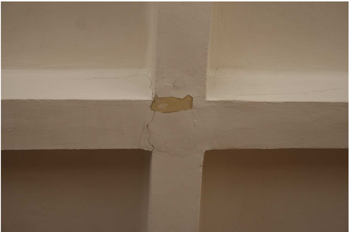
FOT.05. Zarysowania występują na stykach belek poprzecznych z podłużnymi.
